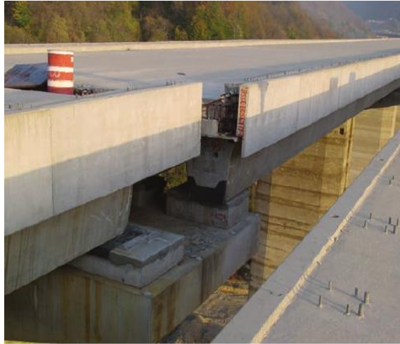
Рис.1. Повреждение виадука Болу во время землетрясения в Дюзде 1999 г.
